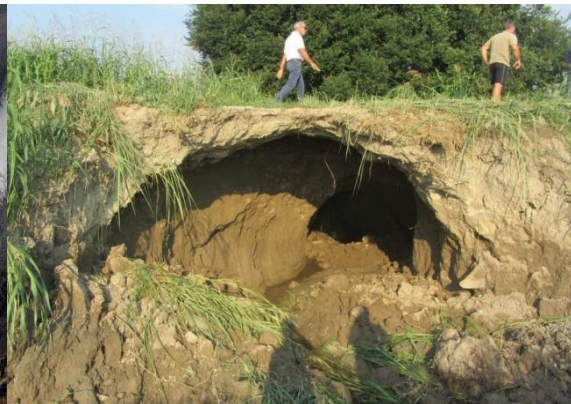
Scavo di un argine causato da nutrie (Legnago, agosto 2015)
