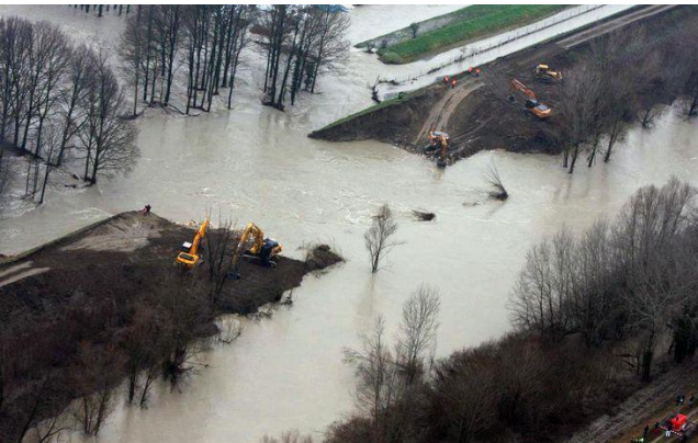
Rottura dell'argine del Secchia (Modena, gennaio 2014)
